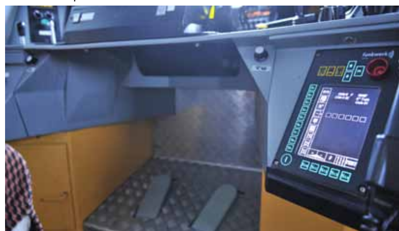
↳ GSM-R dans un poste de conduite
