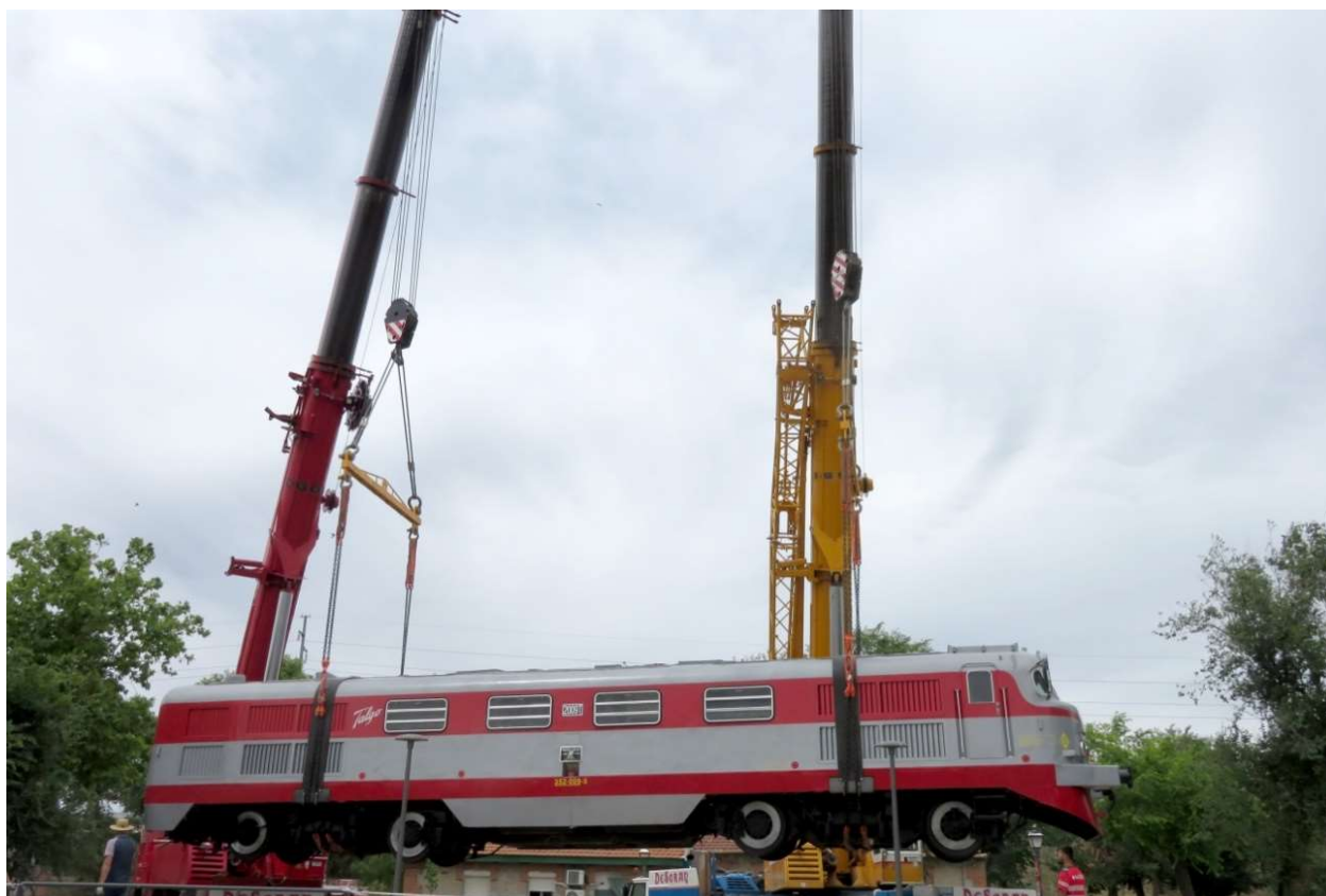
Proceso de colocación de la locomotora Talgo en su emplazamiento definitivo. Las Matas. Foto Chema Martínez Process of placing the Talgo locomotive in its final location. Photo Chema Martínez
