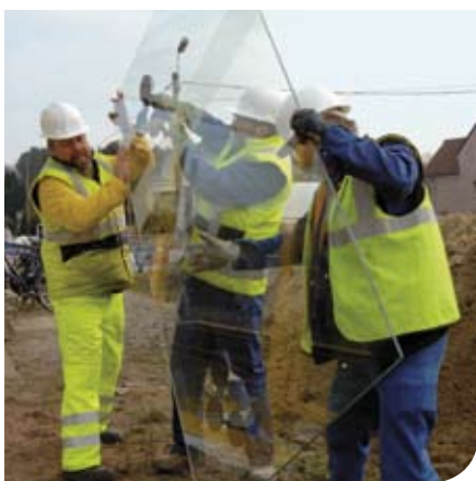
Les vitres de l'abri mobilisent plusieurs opérateurs
