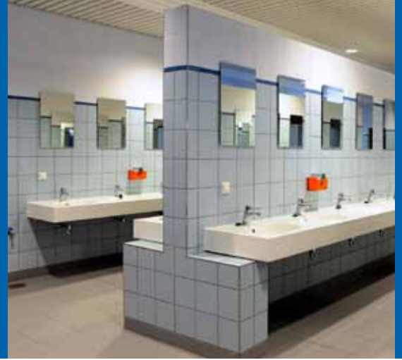
Atelier CLI Équipement sanitaire ultramoderne
