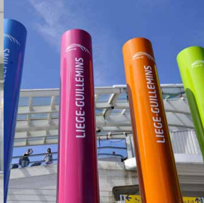
Le passage sous-voies, photographié mi-juillet: la pierre bleue est sous protection jusqu'à la toute fin des travaux.
