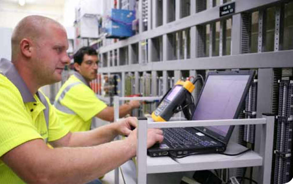
Deux agents du service Courants faibles sont en train de vérifier le bon fonctionnement des installations.
