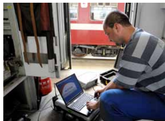
L'ensemble du système TBL1+ est installé sur la rame. Bart De Saedeleer effectue les tests nécessaires et vérifie si tout fonctionne correctement.
