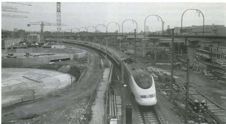
Passage d'un Eurostar pour Londres à hauteur du viaduc de la ligne 96A; cet ouvrage permettra à la voie A de se franchir les deux voies TGV et les deux voies de la ligne 96, et de s'y raccorder à proximité du pont du ring autoroutier. À gauche, les travaux de la station d'épuration. Forest, 5 juillet 1997. Dia : Christian DOSOGNE..
