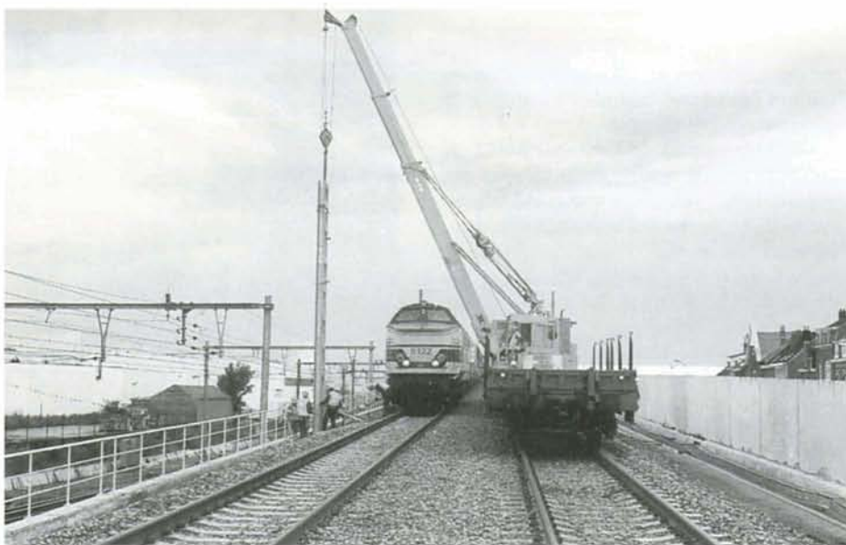
La 5122 en tête du train de béton côtoie la grue Habay sur le viaduc de Lot. Lot, 19 juin 1997. Photo : Yves REYNAERT
