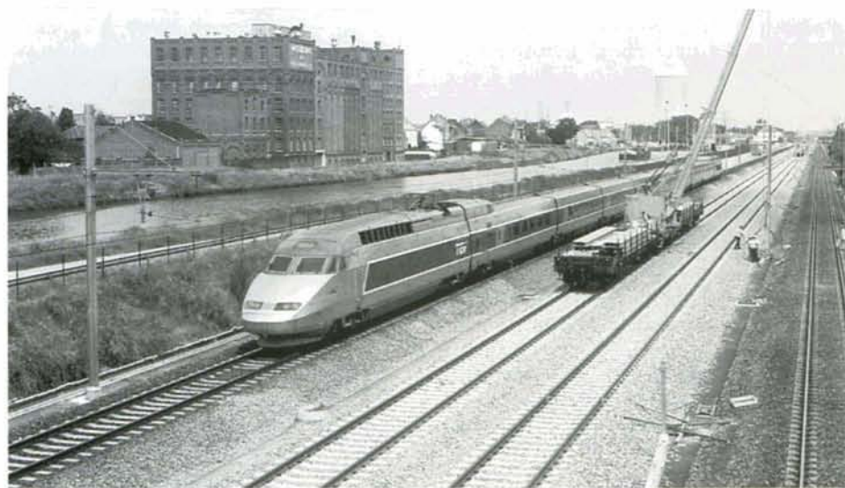
Entre Halle et Ruisbroek, la voie est complètement posée et la mise en place des poteaux caténaires a débuté. Passage d'un TGV « Réseau » Paris-Bruxelles à hauteur des moulins de Ruisbroek le 19 juin. Photo : Yves REYNAERT.
