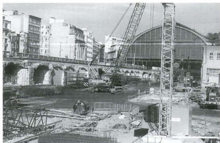
PHOTO 40-71 Le chantier d'Antwerpen-Centraal vu de l'extérieur; à gauche, sur les arcades, passent les deux voies encore en service. Antwerpen, 20 octobre 1999. B. DIEU.
