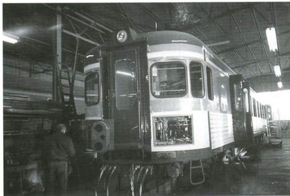
L'ex. voiture AB de l'automotrice 149 en cours de finition. Derrière la cabine de conduite (à droite) se trouve l'armoire haute tension. La fenêtre qui se trouvait à cette hauteur (ex. compartiment de 1ère classe) a été supprimée. Photo : Metalmeccanica Milaneseio.
