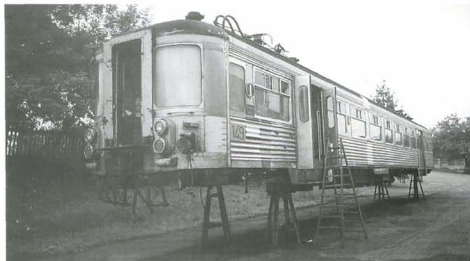
Premiers travaux sur la voiture AB de l'automotrice 149. Des essais de peinture ont été réalisés, à droite du numéro, sur la première porte et au milieu de la caisse.
