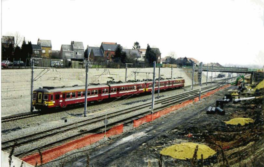
PHOTO 49-87 Zaventem, le 30 janvier 2002. Le train L 3012 Geraardsbergen-Leuven quitte la gare par la nouvelle voie A ligne 36. A droite, les travaux d'élargissement de la plate-forme. Au centre, la voie de garage et la voie B (vers Bruxelles) de la ligne 36. B. DIEU.
