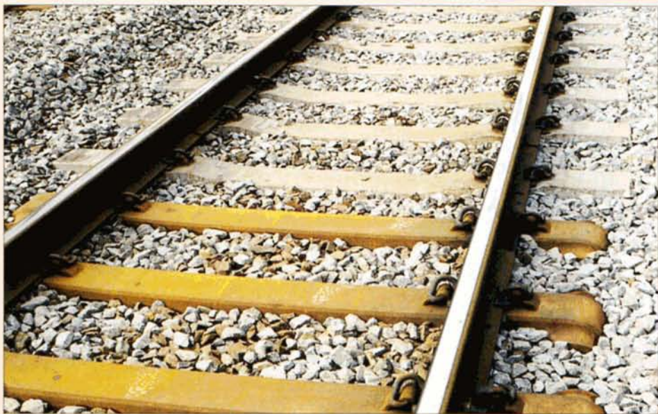
PHOTO 49-31 Le point de raccord entre la zone à traverses en béton et celle en traverses métalliques. Schaerbeek, ligne 161, 10 janvier 2002. J-L VANDERHAEGEN.
