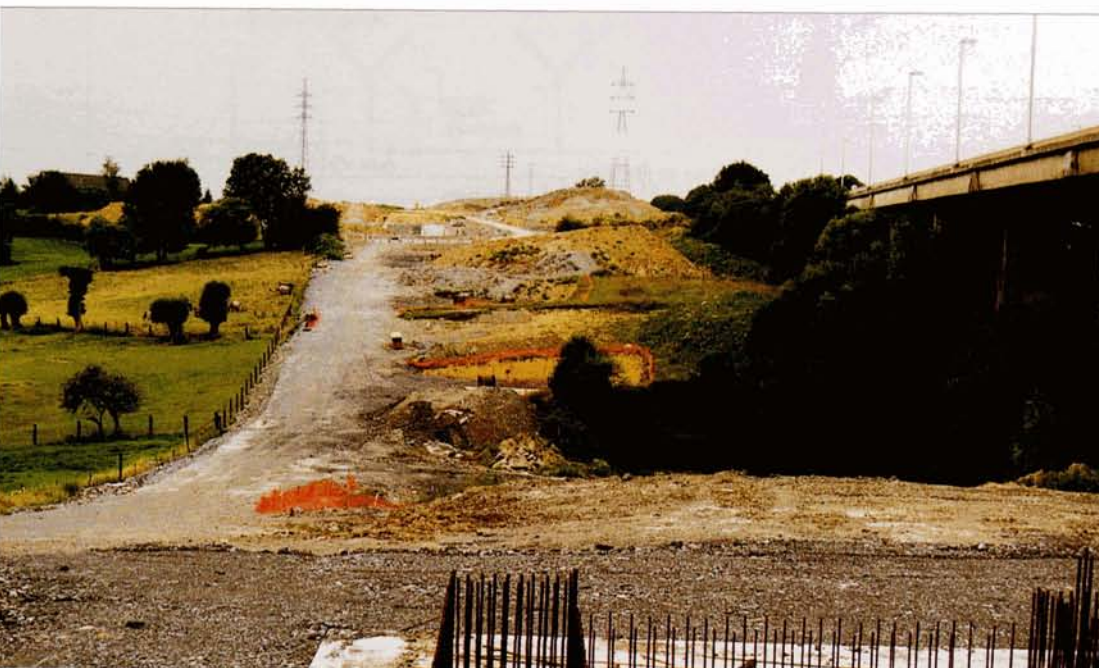
← La ligne nouvelle vers l'Allemagne rejoint l'autoroute E40 près de Herve. Les travaux du viaduc de José, qui sera parallèle à celui de l'autoroute, sont commencés. Les fondations en béton sont prêtes à recevoir les piles. Herve, 9 juillet 2003. Baudouin DIEU.
