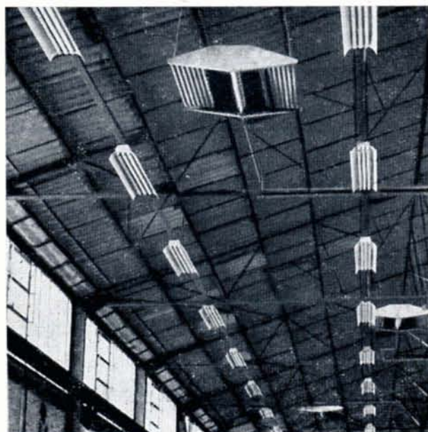
Entre les deux rangées de porte-tubes fluorescents on distingue, au premier plan, un panneau radiant avec, au milieu, la rampe de brûleurs ; à gauche et à droite les panneaux en tôle ondulée.
