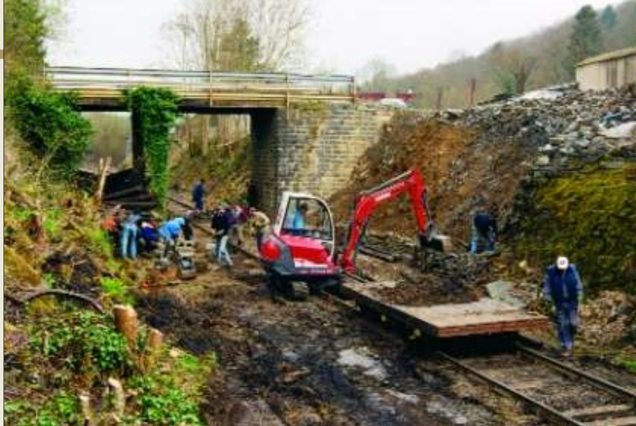
Op 16 april 2000 werd ijverig gewerkt aan de inrit van Dorinne-Durnal. De berm werd verstevigd, het spoor grondig gereinigd en afwateringskanalen aangelegd. TSP.
