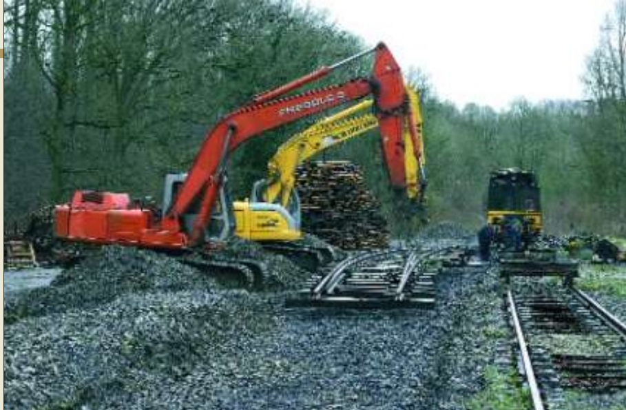
Boven : grootse werken te Spontin op 30 maart 2007 : er werden twee wissels teruggeplaatst om een uitwijkspoor aan te leggen.
