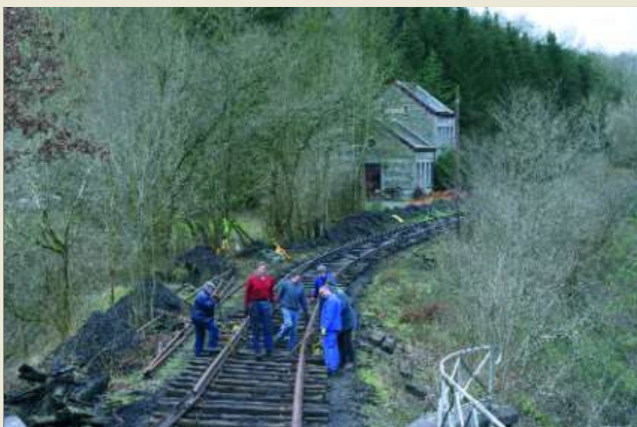
Onder : aanleg van het nieuwe spoor in de nabijheid van het station van Purnode. TSP.
