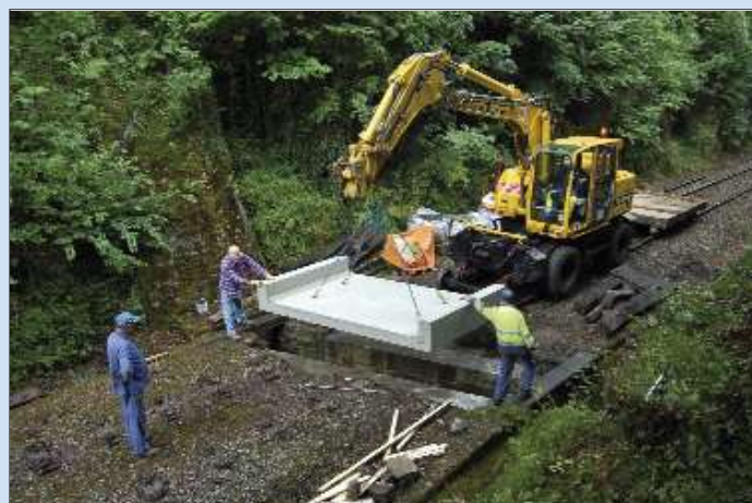
De spoor/wegkraan bij de inbouw van de nieuwe betonnen bedekking. Onze vrijwilligers helpen bij deze delicate operatie. TSP.
