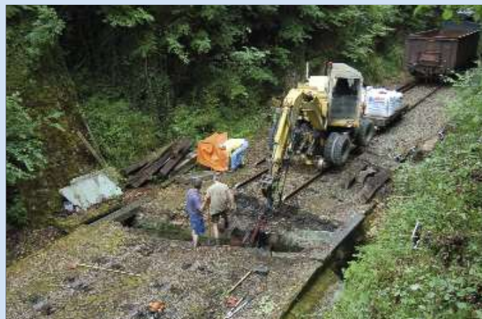
Na de opbraak van het spoor en het verwijderen van de metalen constructie, die na 105 jaar trouwe dienst vervangen moest worden, worden de steunpunten gereinigd en klaargemaakt voor de inbouw van de nieuwe betonnen bedekking. TSP.
