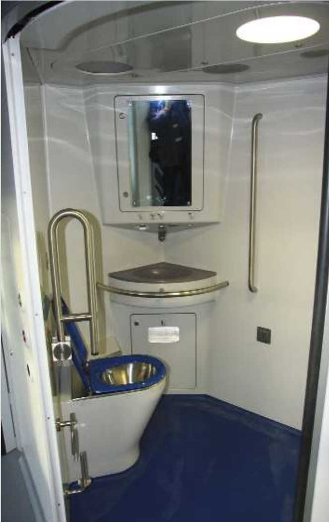
De nieuwe toiletten hebben een gesloten circuit. Op deze foto zien we het toilet naast het multifunctionele compartiment, dat geschikt is voor personen met verminderde mobiliteit.
