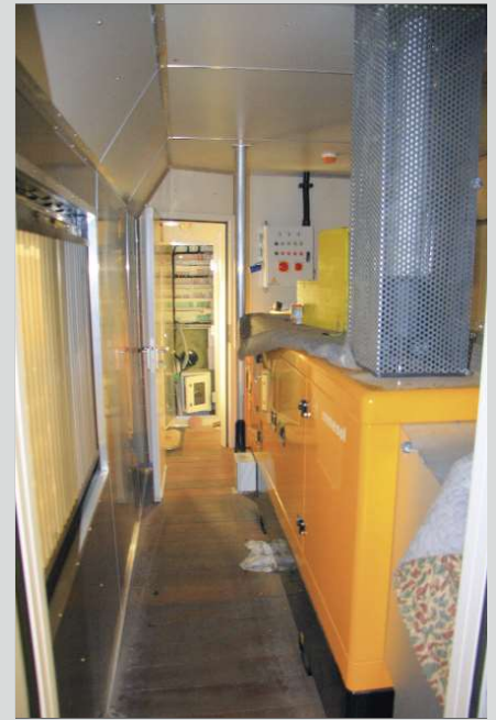
Rechts, het compartiment met de elektroegroep van 60 kW.
