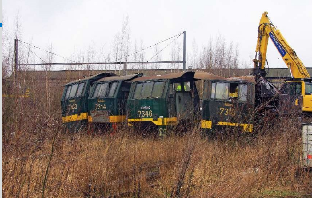
↑ FOTO 114-12 De sloop van de 73'ers van de eerste reeks (7301 t/m 7335) gebeurde op 4 februari te Monceau, met de afbraak van de 7310, 7314 en de 7333. De 7346 (tweede reeks) was eveneens aan de beurt. Pierre HERBIET.
