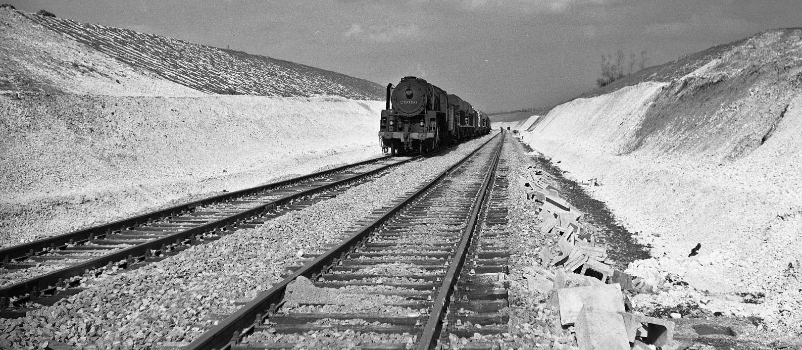
FOTO 114-75 NB In het kader van de elektrificatiewerken op de internationale as Brussel - Paris werd een nieuw tracé gebouwd tussen Cuesmes en Frameries. Op 11 april 1963 is een werktrein aan de slag op dit baanvak, halfweg tussen Cuesmes en Frameries. Hij wordt gesleept door de 29.090 van het depot Brussel-Zuid. Foto Bruno DEDONCKER, verzameling TSP.
