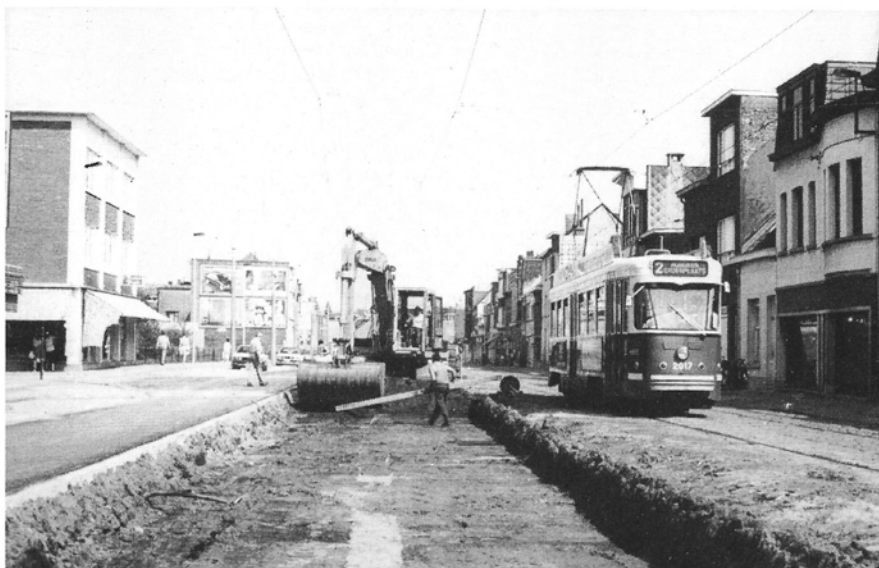
Het uitgraven van de nieuwe trambedding aan de Antwerpsesteenweg te Hoboken. PCC 2017 rijdt op de tot verdwijning gedoemde oude rails. 20 augustus 1987. Foto Eric Keutgens.
