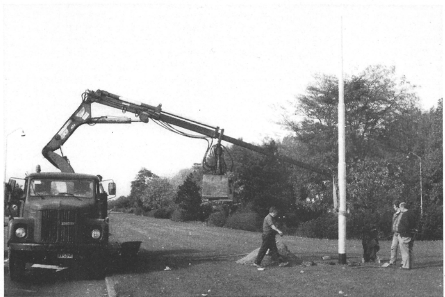
Antwerpen, Linkeroever, woensdag 12 oktober 1988. De eerste bovenleidingspaal op de Blancefloerlaan is zojuist geplant en loodrecht gezet : het aanvullen met betonspecie kan beginnen. Intussen staan er reeds 47 palen, die gedeeltelijk uitgerust zijn met ophangingsarmaturen en bovenleidingsdraad. Foto Eric Keutgens.
