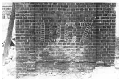
Voetstuk van de hoge schoorsteen, oprichtingsdatum 1887, tijdens de afbraak in 1954. Foto Fr. Keutgens.
