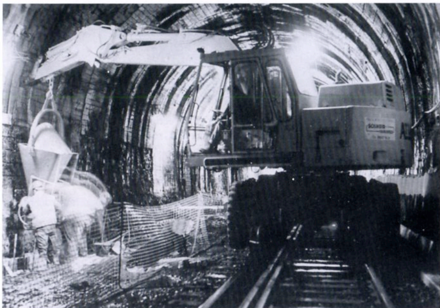
↑ La gare rénovée d'Aywaille ↓ On travaille encore à l'intérieur du tunnel de Coo ( ligne 42 ) pour dégager le gabarit électrique 25 kV (photos D. MOINIL-SNCB)
