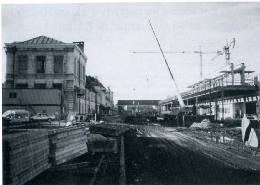
Namur en chantier le 6 janvier 1999 : à gauche, façade arrière (ex-quai 1) de la gare, à droite dalle sur les voies 5 à 11, avec, en avant-plan, la superstructure protégeant la voie 4 en service, au centre, terrassement des ex-voies 1 à 3 avec au fond le tunnel aérien provisoire d'accès aux quais 4 à 11 (photo M. Lebeau)
