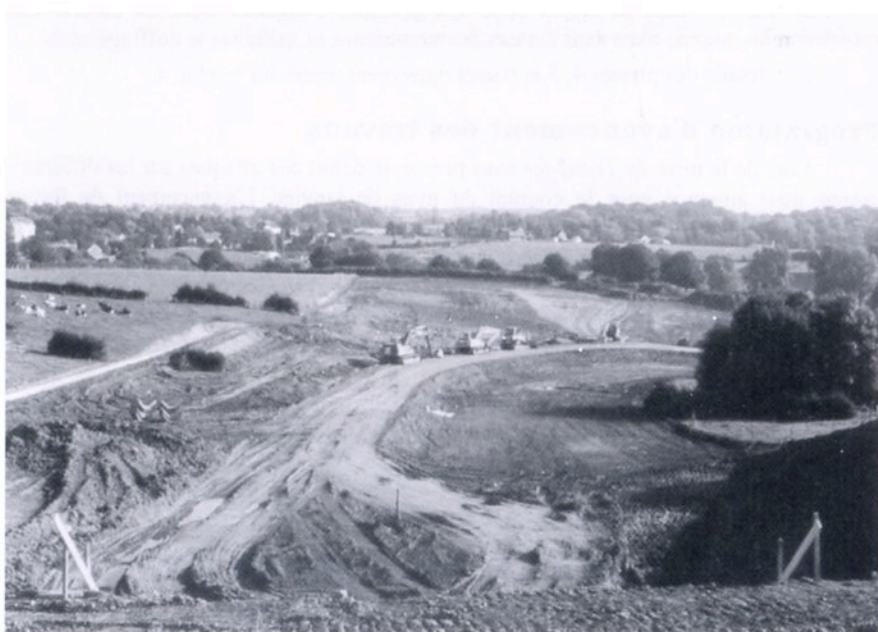
Chantier de la LGV 3 à Ayeneux - Soumagne, à l'est du tunnel ( photos G. Close)
