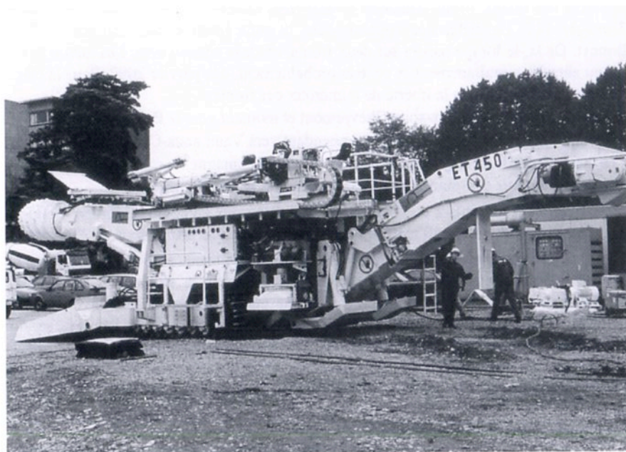
Photo de la haveuse utilisée pour le forage du tunnel routier sous la colline de Cointe (Liège). Trois engins identiques seront utilisés pour le tunnel de Soumagne (photo coll. P. Baar – TUC-Rail)
