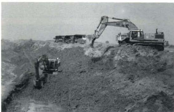
A hauteur de la future bifurcation vers la ligne 78, creusement de la tranchée à l'aide d'énormes engins de terrassement.
