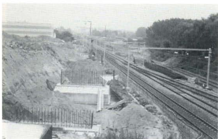
A Lembeek, les deux voies TGV enjamberont la ligne 96 à l'aide d'un viaduc. On distingue à l'avant-plan les piles en construction. A droite, la nouvelle bifurcation de la ligne 106 vers Clabecq, déplacée de 400 mètres environ. Ph. B. Dieu, 15.06.94.
