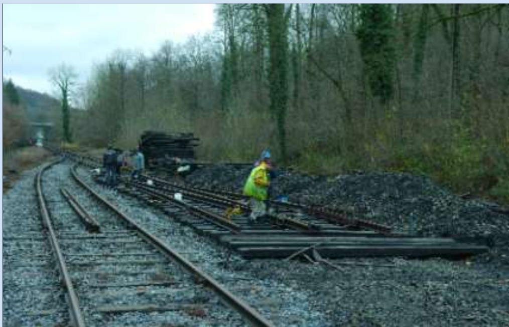
Le 16 novembre 2008, l'équipe du Chemin de Fer de Bocq travaillait à la pause d'un nouvel aiguillage dans la gare de Dorinne-Durnal, qui permettra l'accès à une voie de garage supplémentaire à poser durant l'hiver. PFT.
