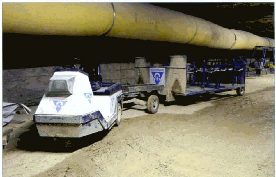
↑ Le transport du personnel sur le chantier s'effectue dans des « wagonnets » attelés à un tracteur électrique.
