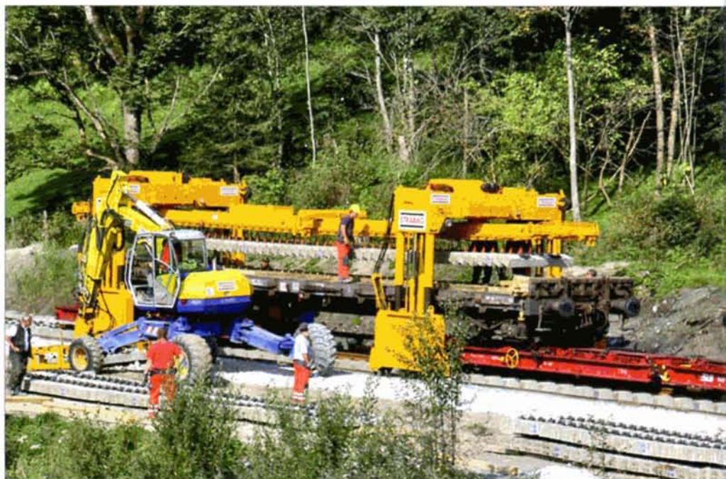
Pour le déchargement des traverses en béton, un portique est utilisé, lequel peut soulever simultanément toutes les traverses présentes sur le wagon et ensuite les placer sur l'assiette de la voie. Photo prise entre Mittersill et Rettenbach le 22 septembre 2009. Walter PINET.
