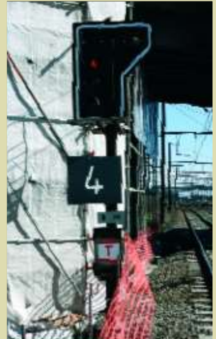
Het sein N29 beschermt de inrit van het station Merelbeke, komende van Gent St. Pieters op de lijn 50E. Op dit sein werd de gele driehoek vervangen door het nieuwe zwarte vierkante bord. 1 april 2006.
