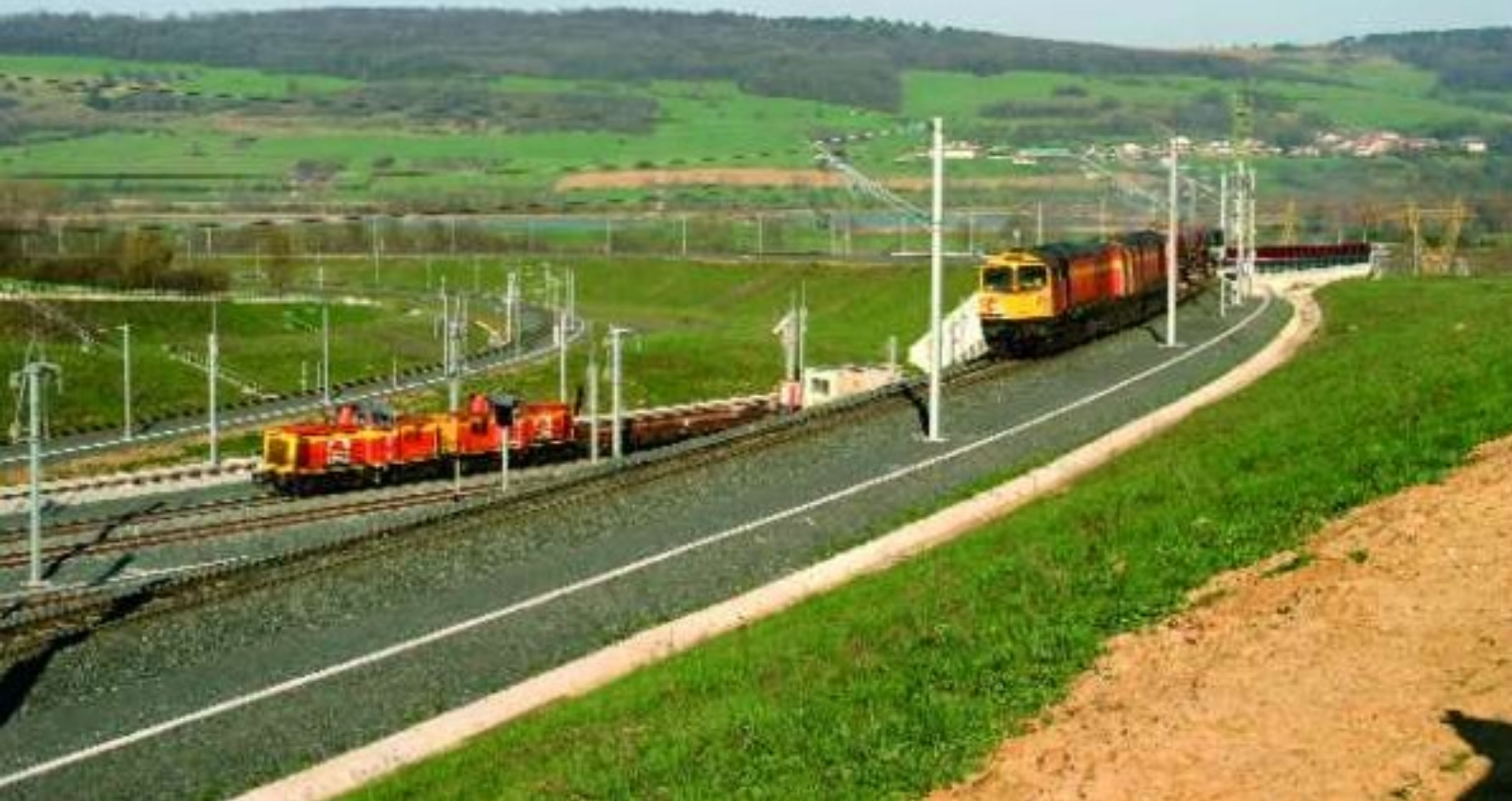
FOTO 74-19 In Prény bevindt zich de vertakking - met een niet-gelijkgrondse kruising - richting Pagny-sur-Moselle en Metz. Links een werktrein van SECO-Rail met twee locomotieven ex-211 van de DB op tegenspoor op het spoor Paris - Strasbourg. Rechts op de overbrugging een ballasttrein gesleept door 58009 en 58040 van SECO-Rail. Het gaat om een bij het Britse EWS gehuurde Class58. Pierre HERBIET, 6 april 2006.
