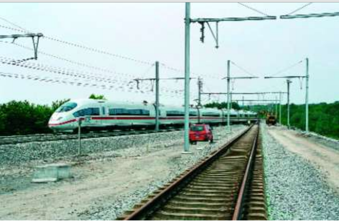
De vertakking Hammerbrücke waar de lijnen 4 en 37 samenkomen. De passerende ICE naar Köln zal over enkele maanden over het spoor op de voorgrond rijden... Baudouin DIEU, 7 juni 2006.
