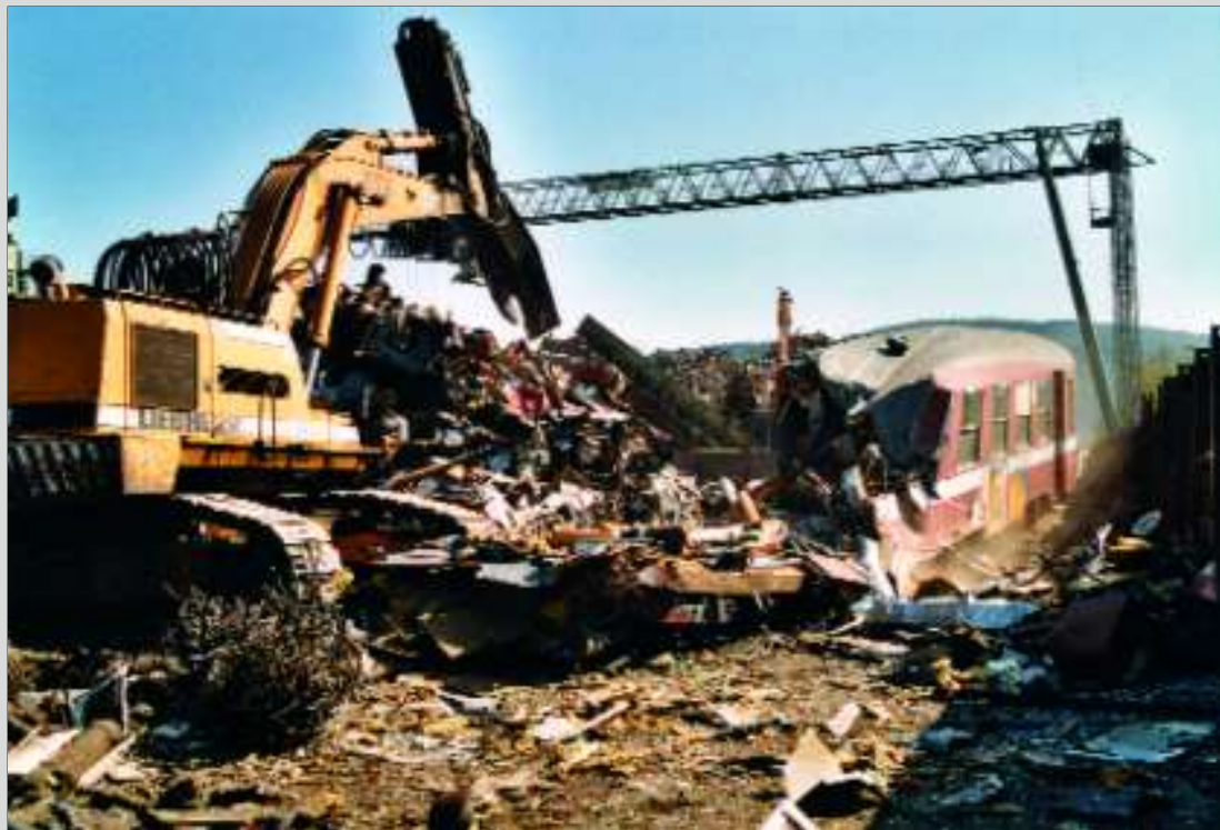
Een beeld van de sloopwerken van de K4-rijtuigen op de schrootwerf Steil in de haven van Trier.
