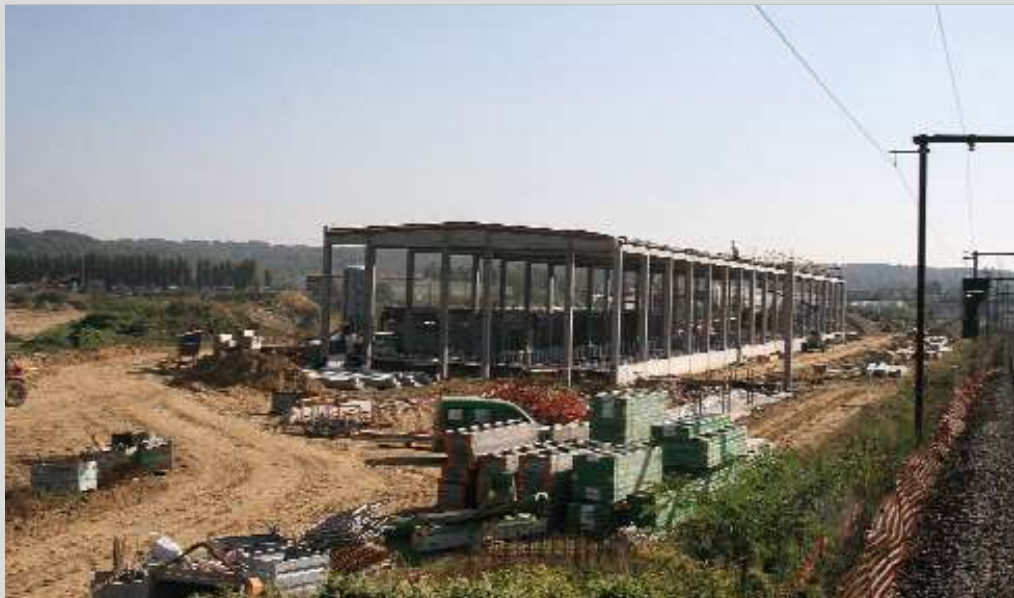
De constructie van de ruwbouw van de nieuwe onderhouds- en herstellingspost te Ottignies schiet goed op. De 110 meter lange hall zal twee sporen krijgen (zie OP DE BAAN 103 bladzijde. 21) Jean-Luc VANDERHAEGEN, 30 september 2011.
