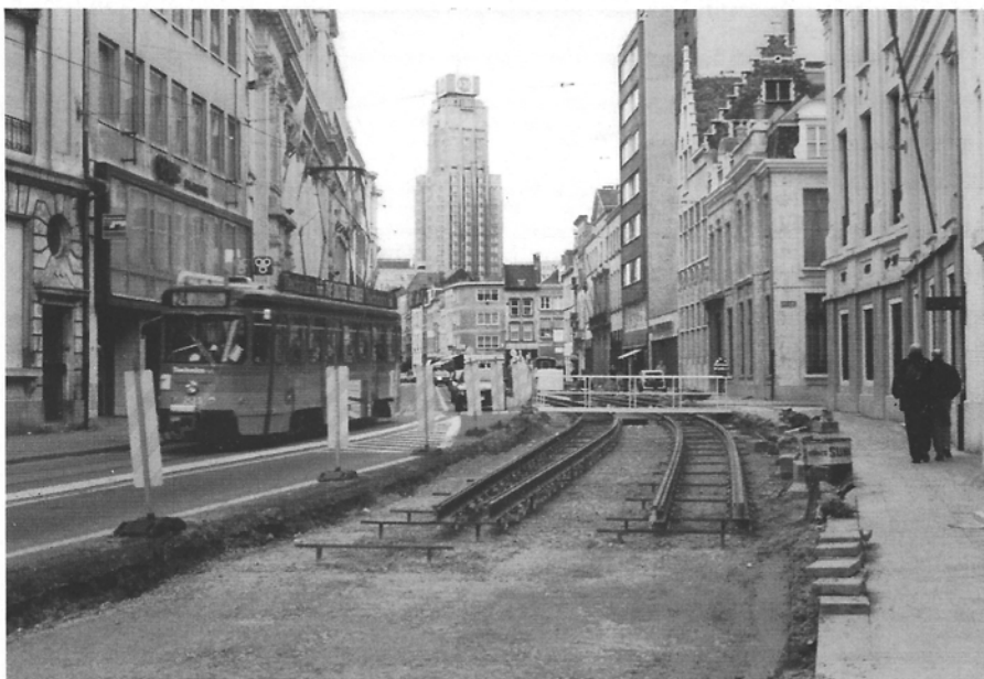
Antwerpen, 4 april 1992. Aanleg van de eigen bedding met dubbelsporige trambaan in de Lange Gasthuisstraat. Links PCC-rijtuig 2123, met „Technics”-publiciteit. Foto Eric Keutgens.
