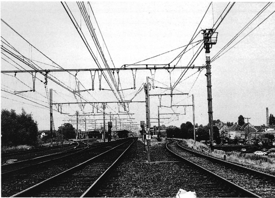
In Lokeren bleef het aantal sporen beperkt tot vijf doorgaande hoofdsporen. Het rechtse doodspoor, waarop in het verleden alléén de treinen uit Dendermonde werden ontvangen, is pas later geëlektrificeerd. Dit doodspoor is overigens volledig onafhankelijk van lijn 59. Foto Jan Mahieu.
