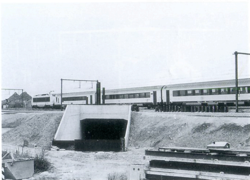
Zaventem : train IC Ostende-Eupen remorqué par la locomotive 1324. Construction, du passage inférieur de la future voie « B » raccordement Nossegem - aéroport (diabolo de Zaventem) - photo M. Grieten - 07.08.00
