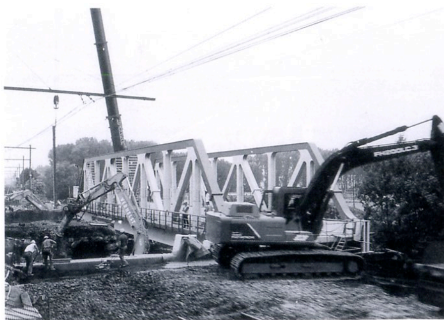
Denderleeuw (ligne 50) : construction du nouveau pont sur la Dendre : phase de ripage le samedi 10.06.00 alors que la ligne était interrompue (photo M. Grieten)
