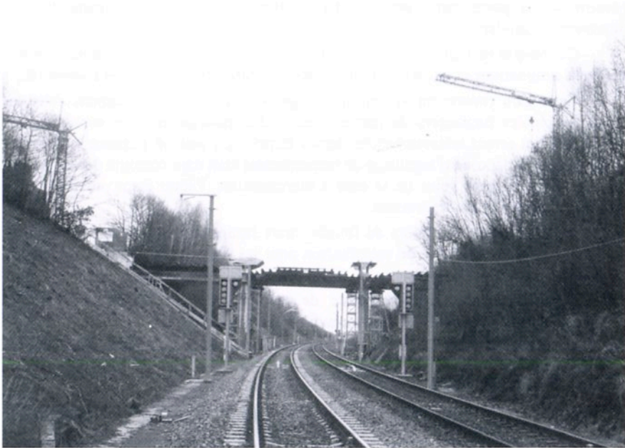
Vue générale du chantier de reconstruction de l'ancien pont vicinal. Florenville, 6 janvier 2001 (photo de l'auteur)
