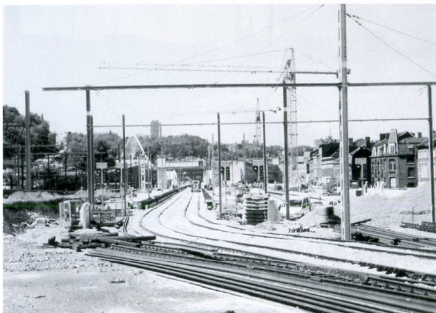
Futures voies 3 et 4 en cours de pose dans l'enfilade de l'ancienne gare des Guillemins (photo A. Spailier - 17.05.02)
