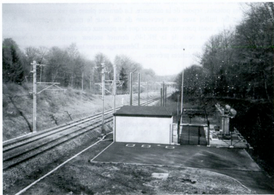
Une vue du poste autotransformateur d' Izel, commune de Chiny, situé exactement face à la BK 100. (17.04.02 – photo de l'auteur)
