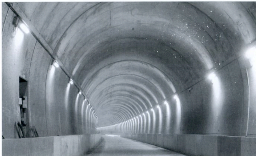
Le tunnel terminé avec son éclairage définitif et ses quais de secours (Photo Infrabel)
