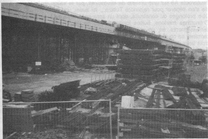
Travaux du viaduc d'Arbre lors du passage de l'excursion GTF du 27 mai 1995 (photo R. Marganne)
