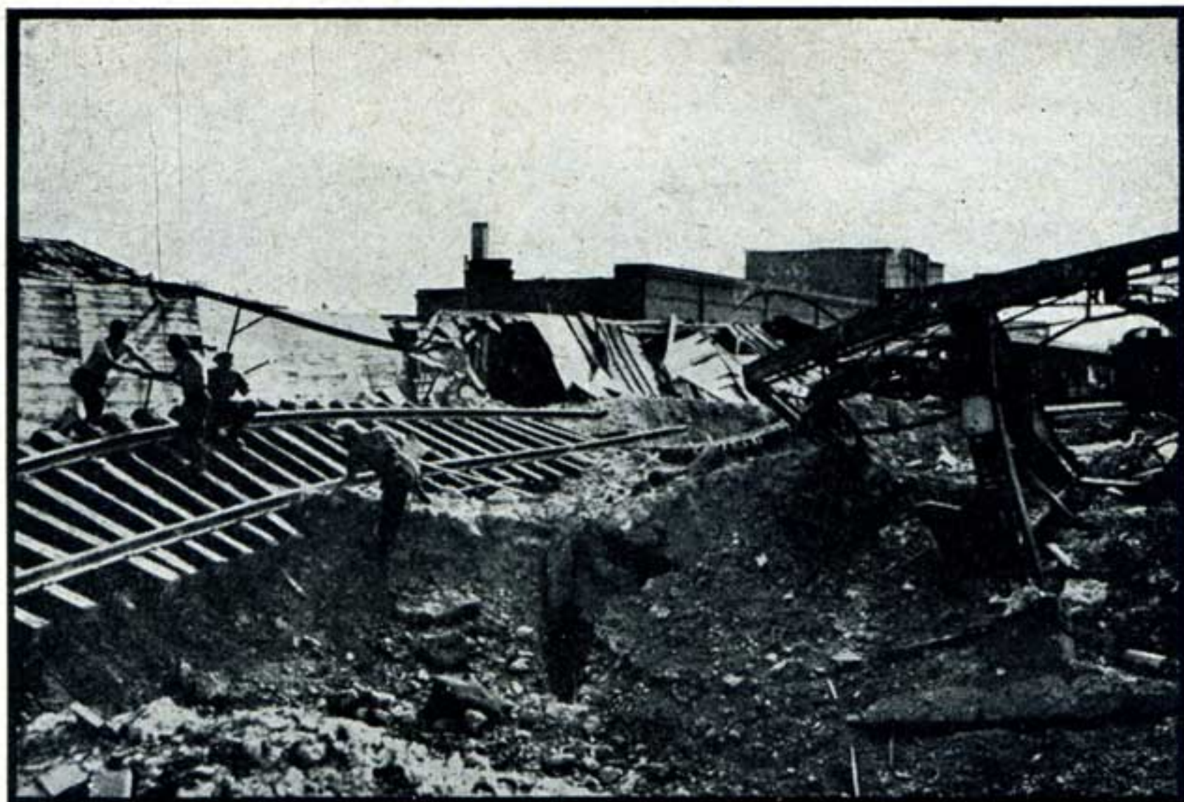
Dans Caen libérée, une compagnie du Génie de l'Armée Britannique entreprend les premiers travaux de reconstruction.
