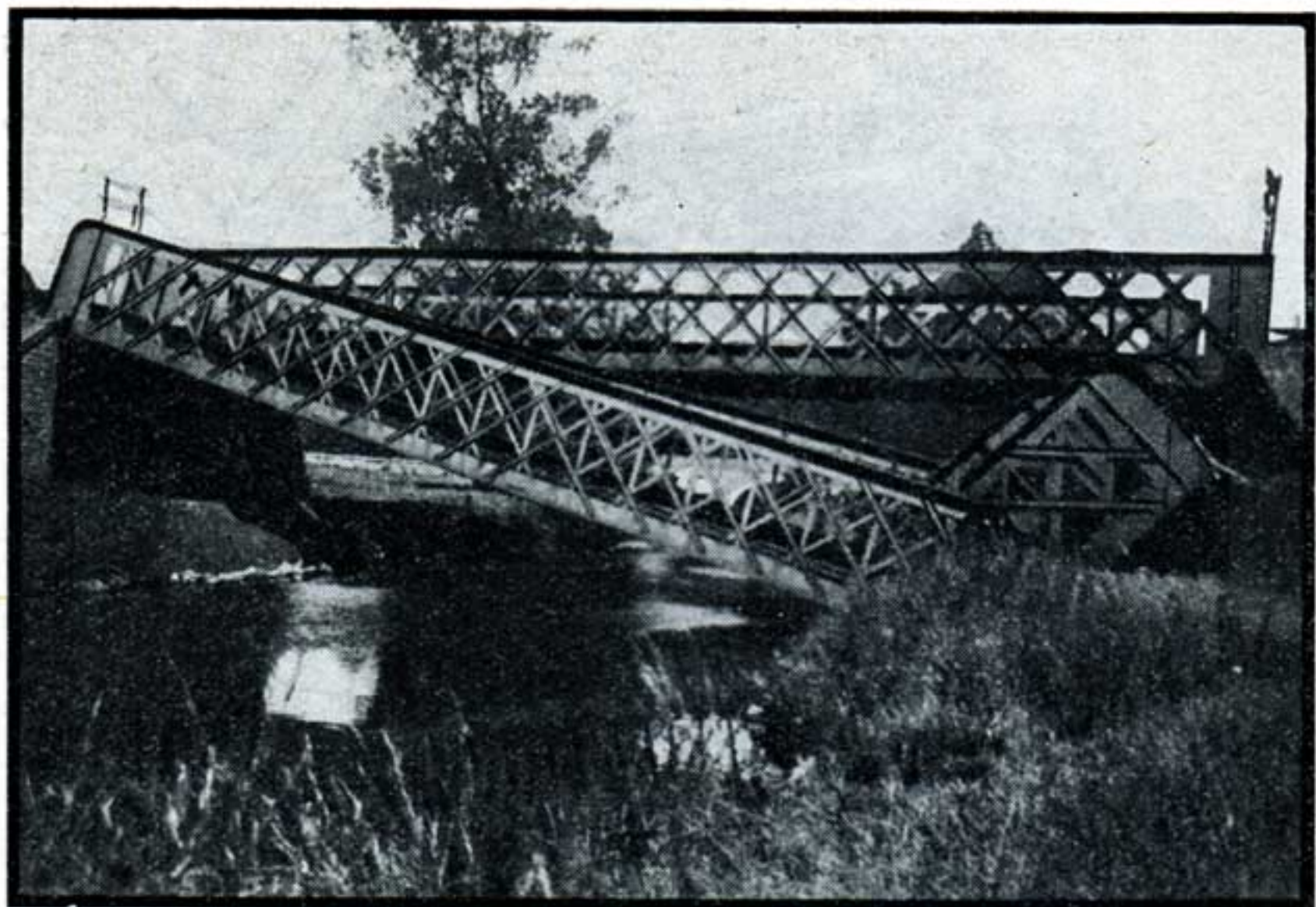
Résultat de l'attentat du 5 juillet 1944 sur le pont C. K. 18709 de la ligne de : Le Coteau à Montchanin.
