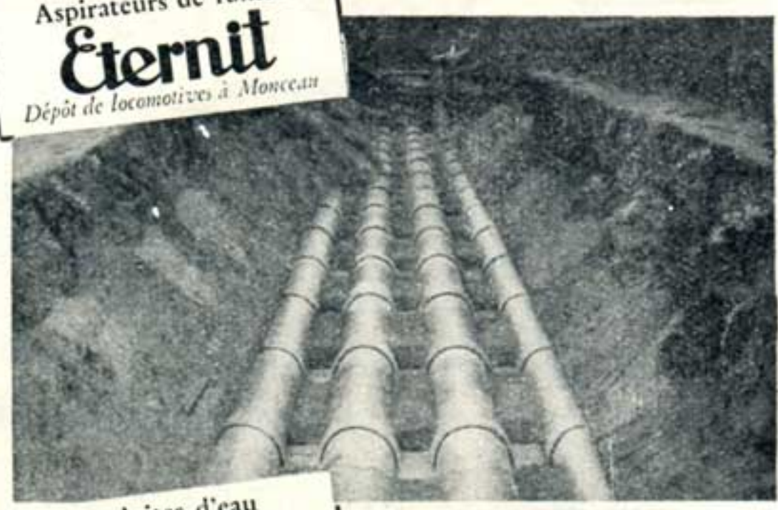
Conduites d'eau Éternit Charbonnages Limbourg-Meuse, Fyden
