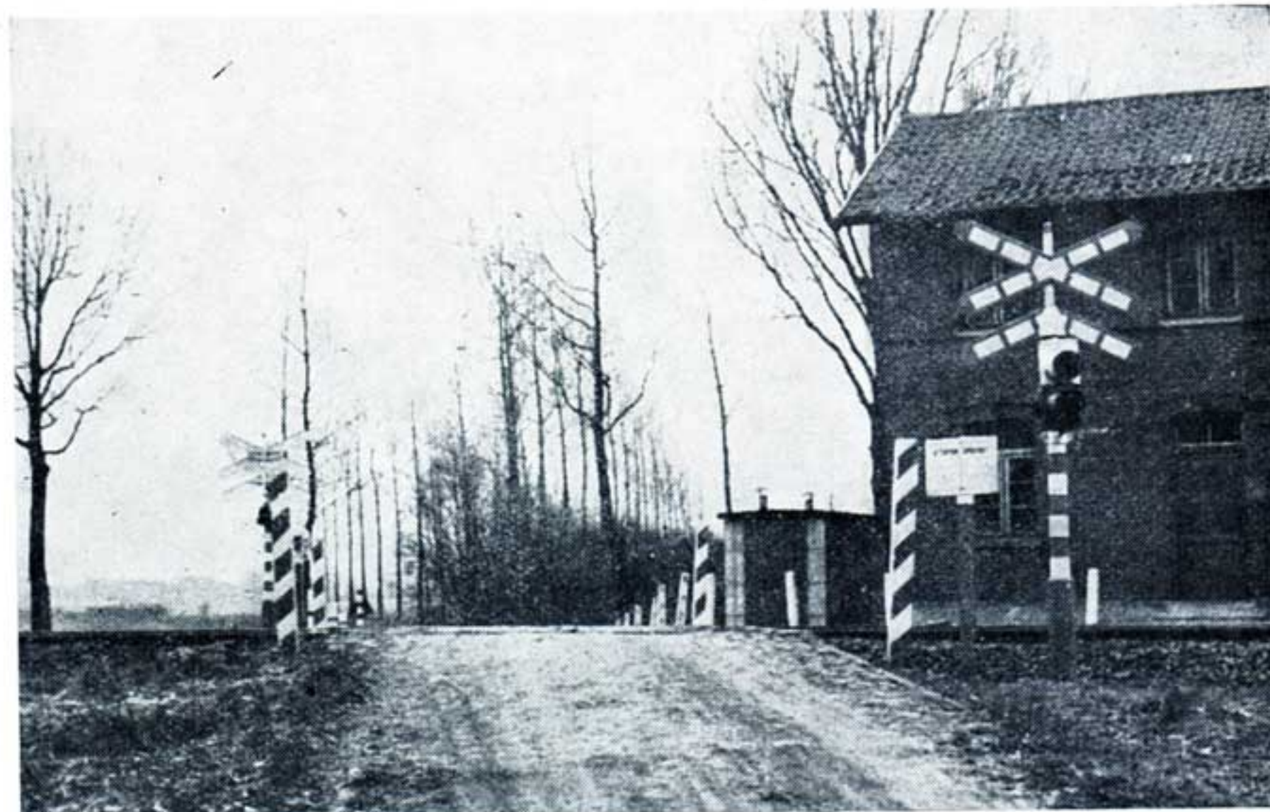
Fig. 16. — Signalisation automatique de passage à niveau non gardé.
