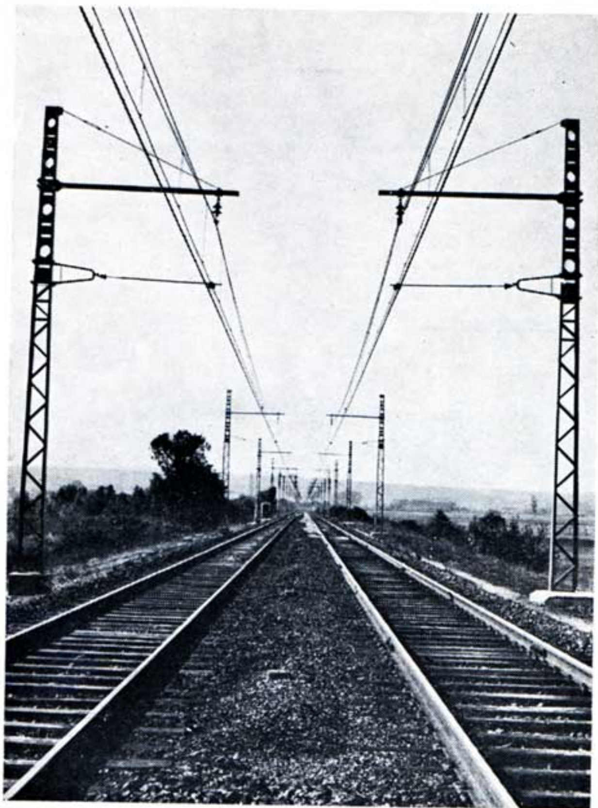
Fig. 3. — Zone à 2 voies équipée avec supports métalliques indépendants.
