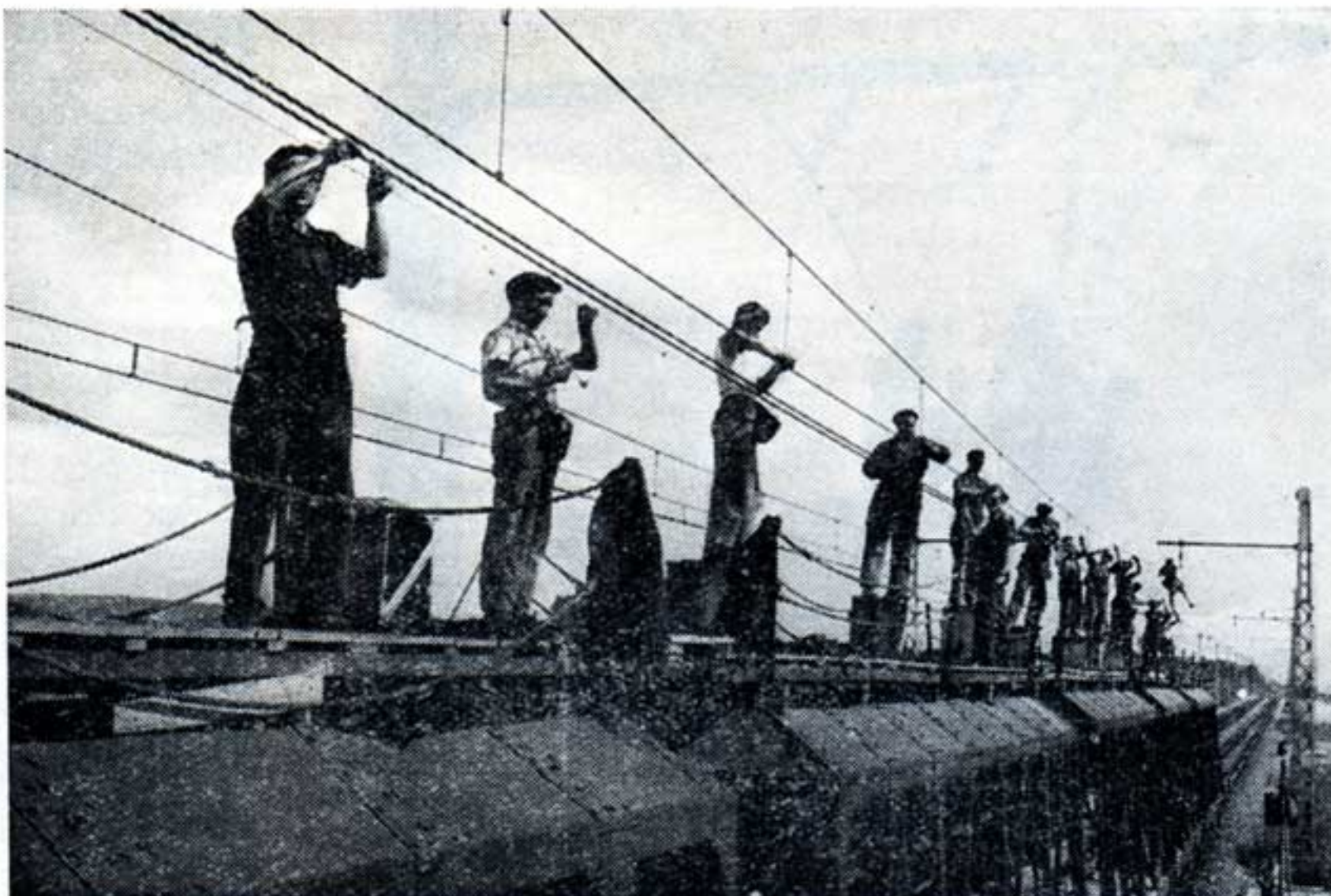
La mise en place des étriers dits pendules reliant les fils et les câbles de la caténaire par de fortes équipes à l'aide d'un train spécialisé.
