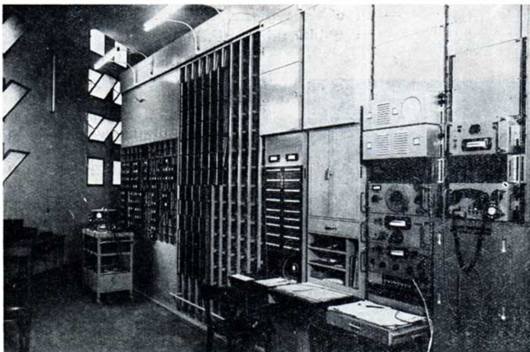
Fig. 14. — Vue intérieure de la station des répéteurs de Paris.
