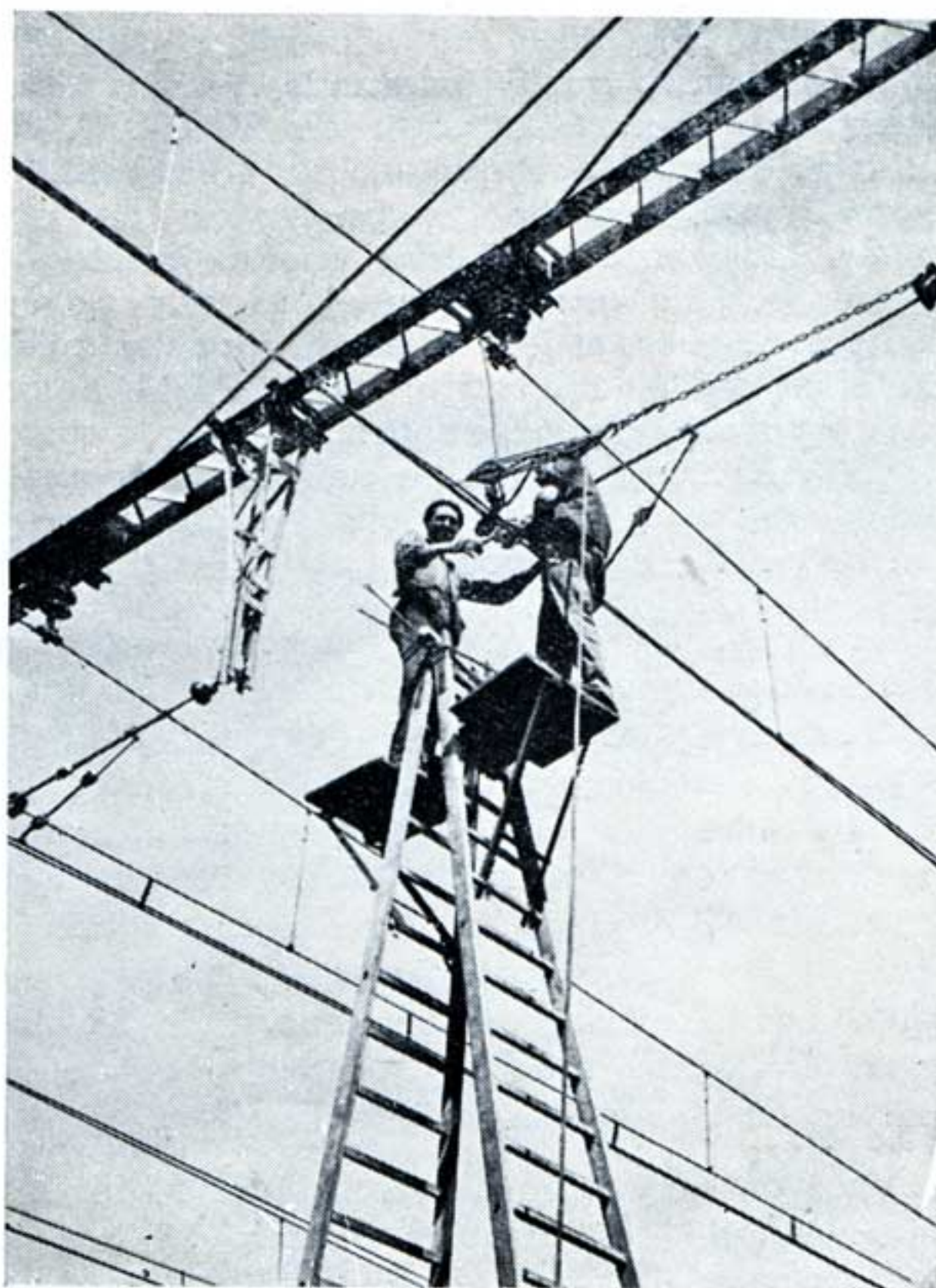
La mise en place des étriers « dits pendules » reliant les fils et les câbles de la caténaire par petites équipes.
