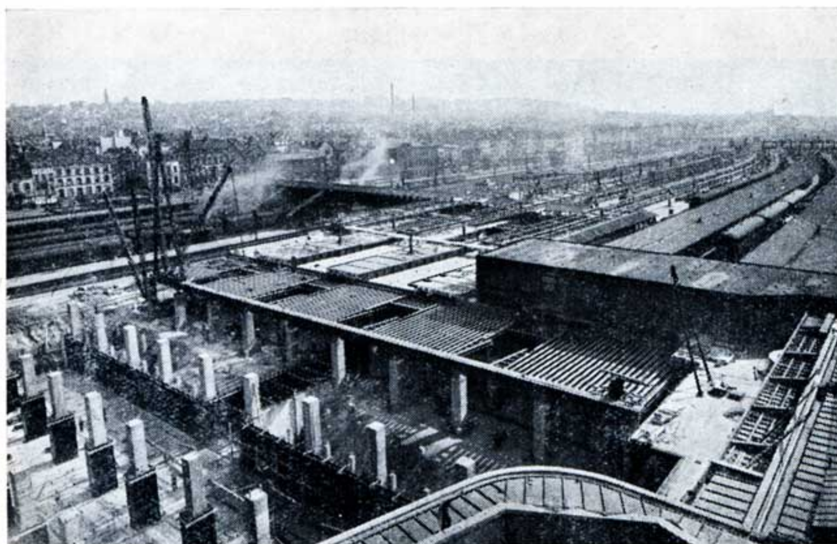
Overzicht van de werken op het einde van 1947, met de voorlopige voetbrug.
