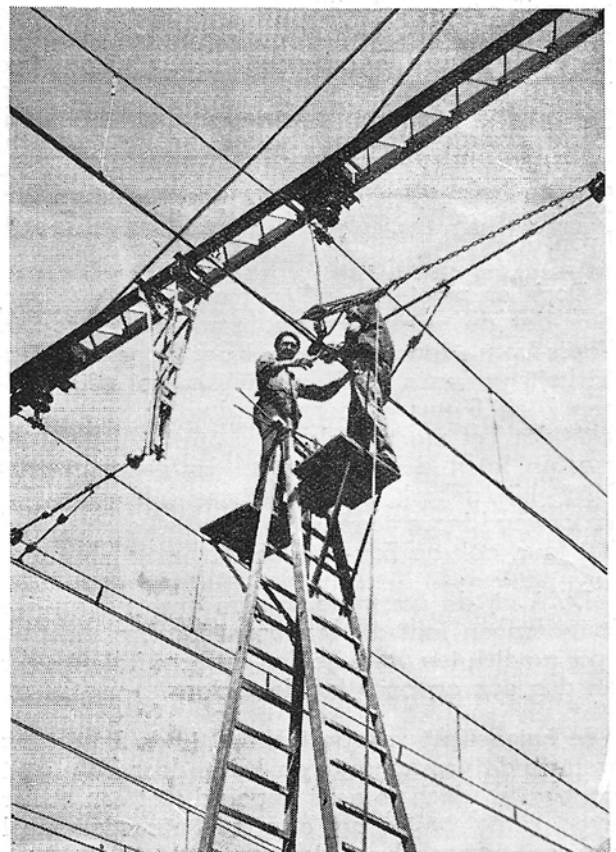
Aanleggen van de hangbeugels tot verbinding van draden en kabels der bovenleiding, met kleine ploegen.
