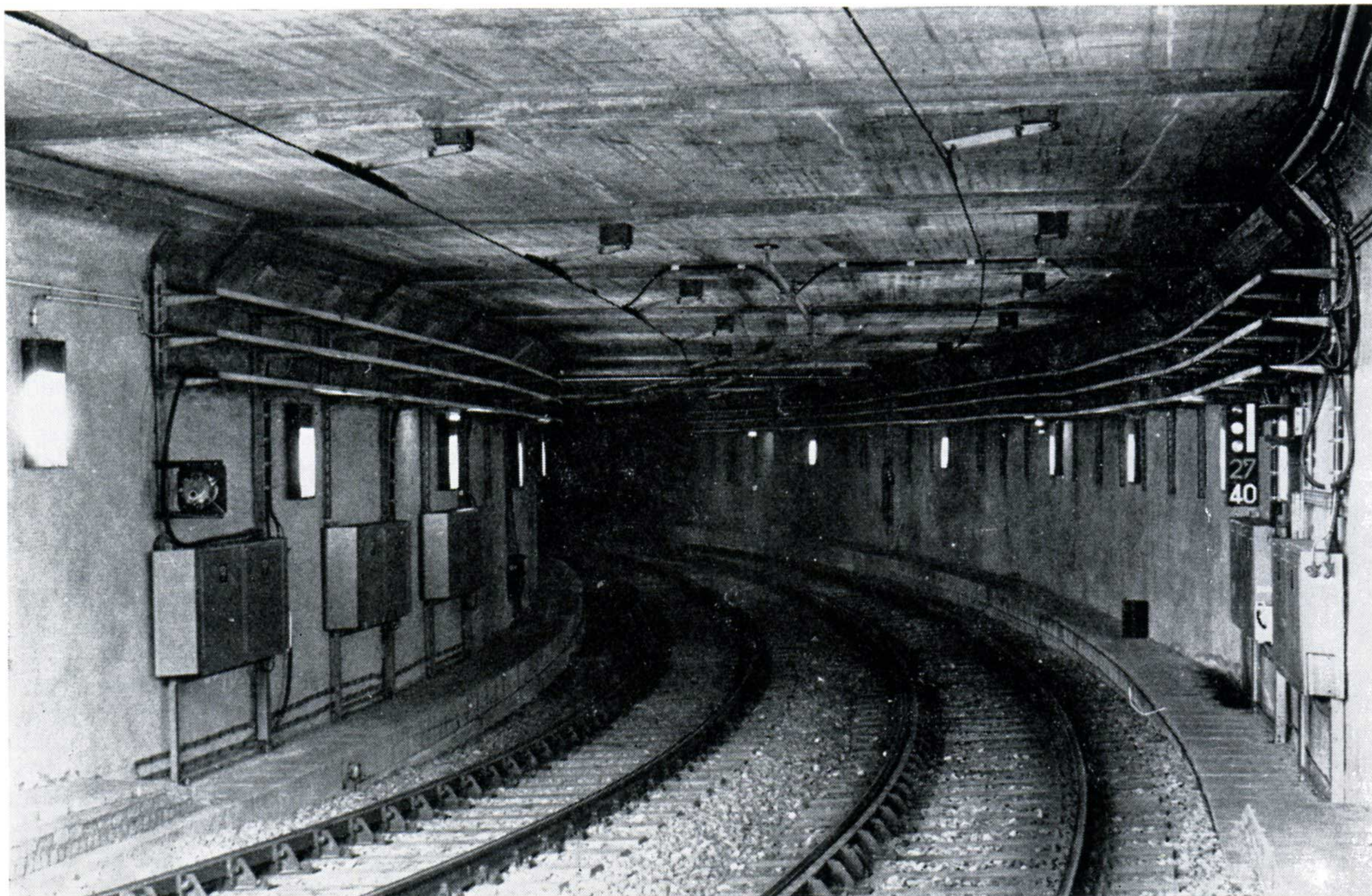
Ligne de contact en tunnel; on notera les fixations au plafond par bras articulés, et un peu à l'arrière-plan, l'extrémité du feeder et son repiquage sur les lignes de contact (photo de l'auteur)
