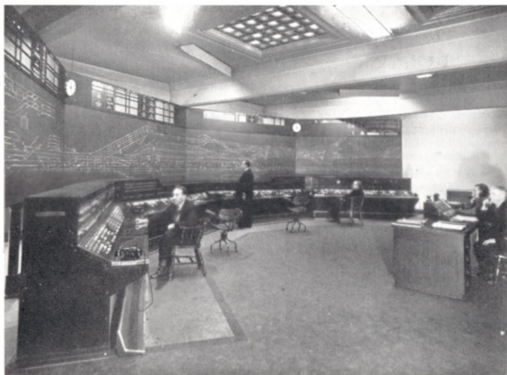
Commande centralisée de la nouvelle signalisation à York. Ce poste commande 54 km. de voie et les 16 quais de la gare. (Photo British Railways)
