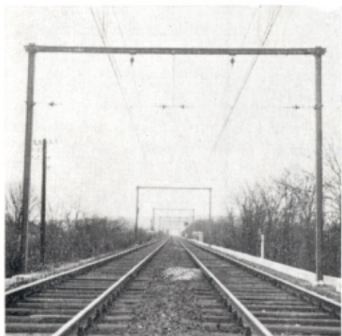
Fig. 7 — Portique standard de pleine voie sur la ligne de Gand.
