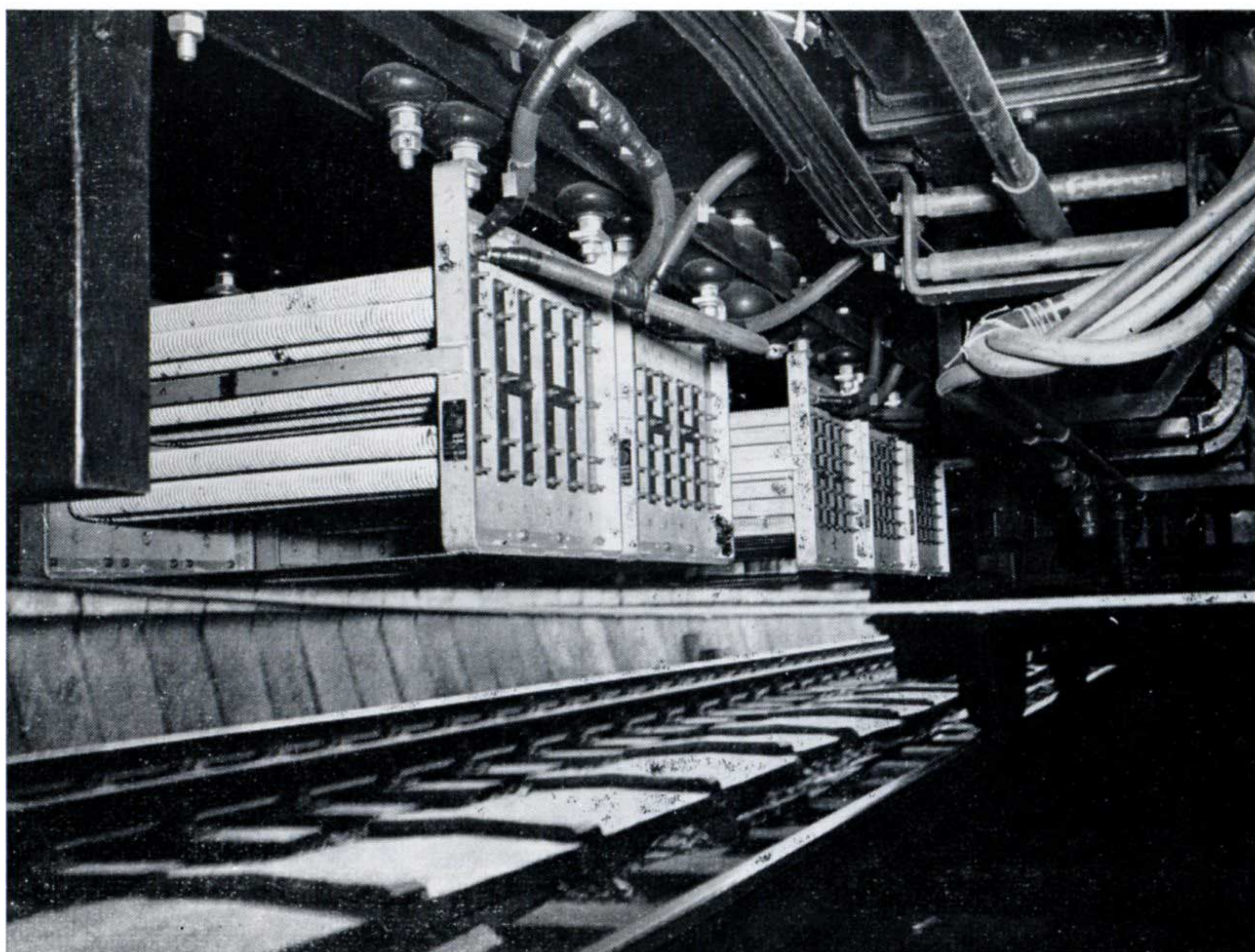
Résistances de démarrage (éléments blindés « Calrod ») montées sous la caisse. (Photo S.E.M.)
