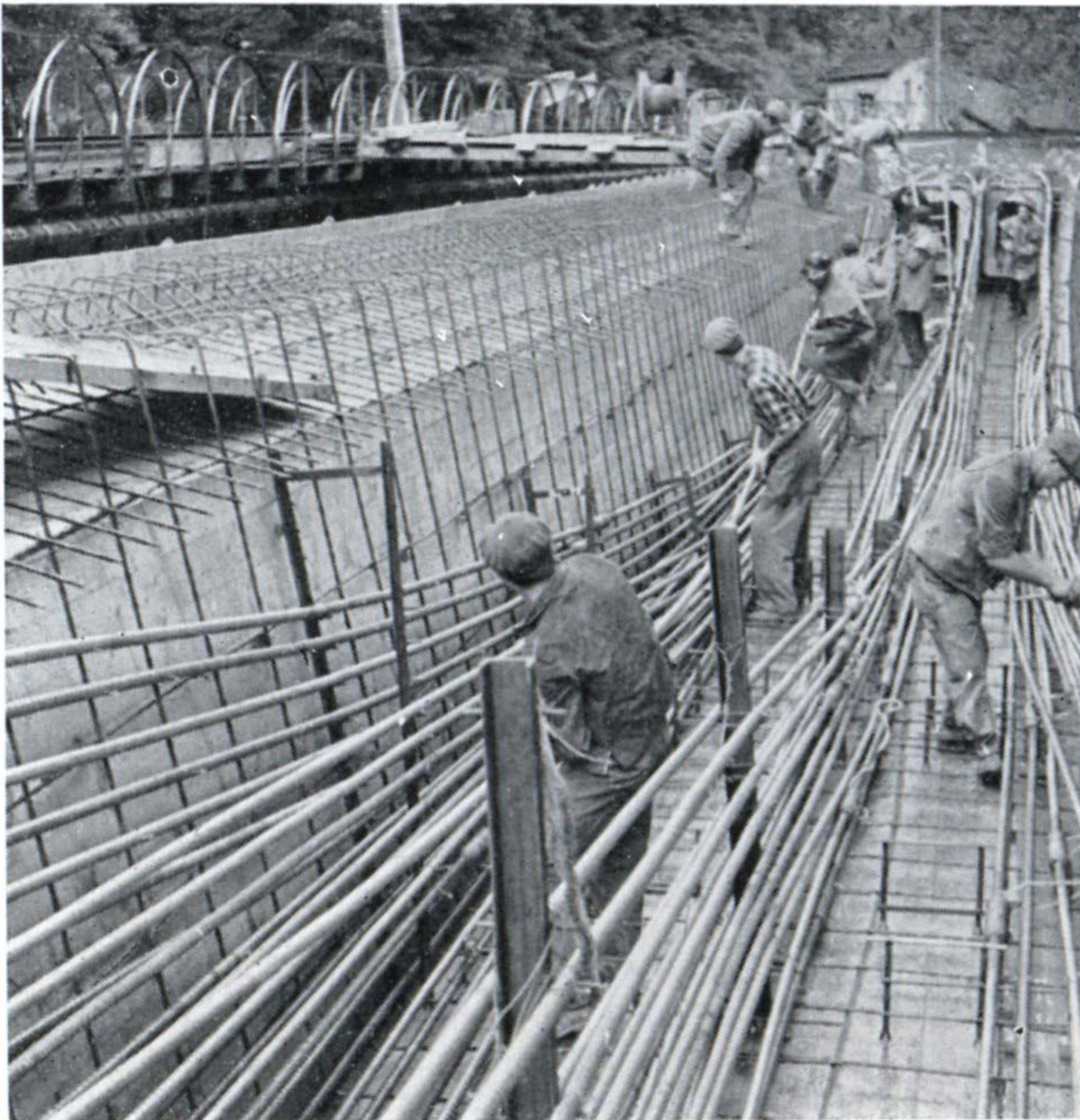
Pose des éléments de précontrainte sur des étriers spéciaux dans le coffrage.
