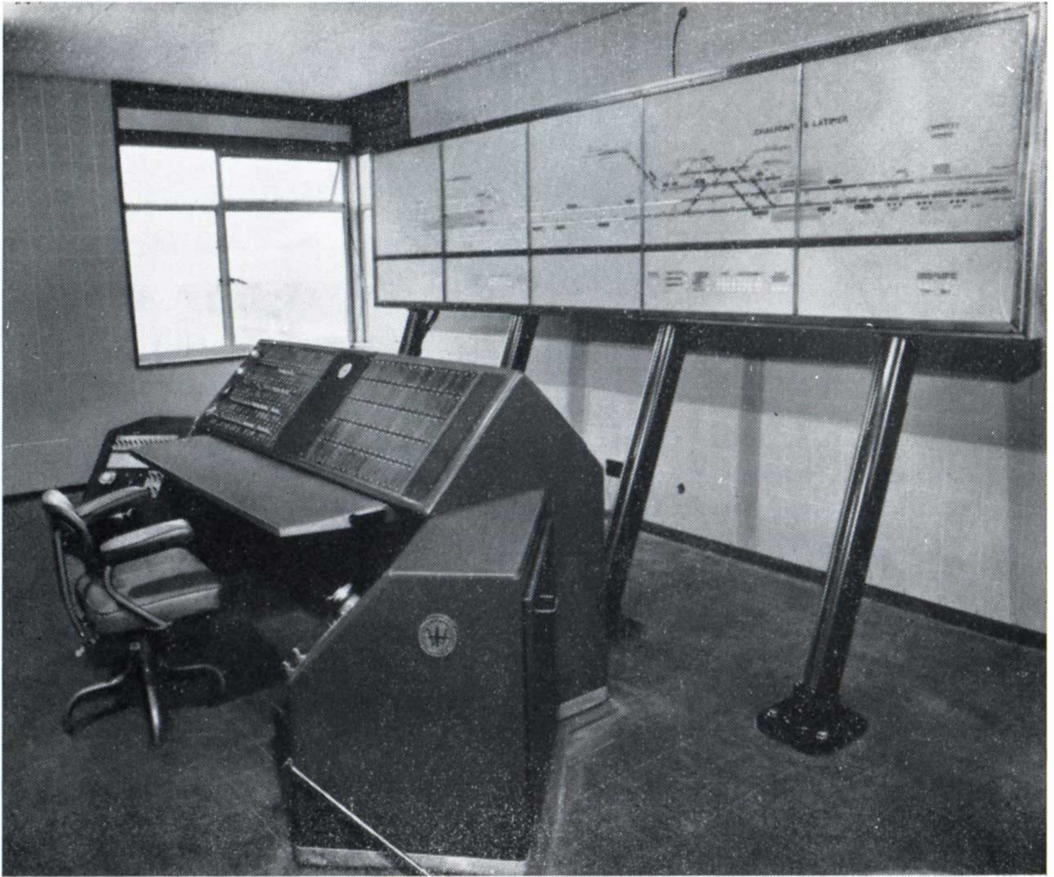
Intérieur de la nouvelle cabine d'Amersham, sur la Metropolitan Line (London Transport) (Photo London Transport Executive)
